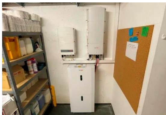
Jugendhaus, PV-Batterie, Wechselrichter, Notstrom-Umschaltung
