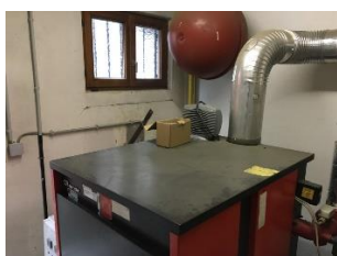
Alter atmosphärischer Gas-Heizkessel
