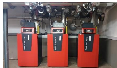
Neue 3-er Gas-Brennwert- Kaskaden-Heizkessel
