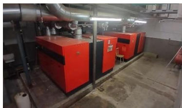
Alte 4-er Gas-Heizkessel-Anlage
