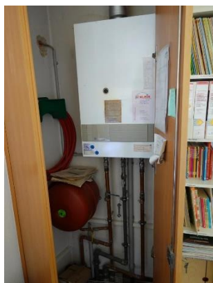
Alter atmosphärischer Gas-Wand-Heizkessel
