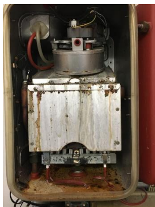
Zustand des alten Brenners
