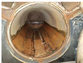
Ausfall des alten Gas-Heizkessel durch Korrosion 04-2024
