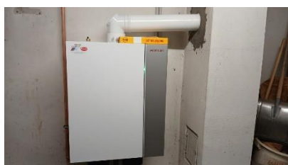
Neuer Gas-Brennwert Heizkessel
