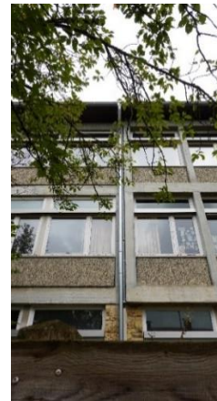
PV-Kabelführung außen an der Fassade
