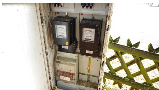
Einspeisezähler Mittel- und Oberbau
