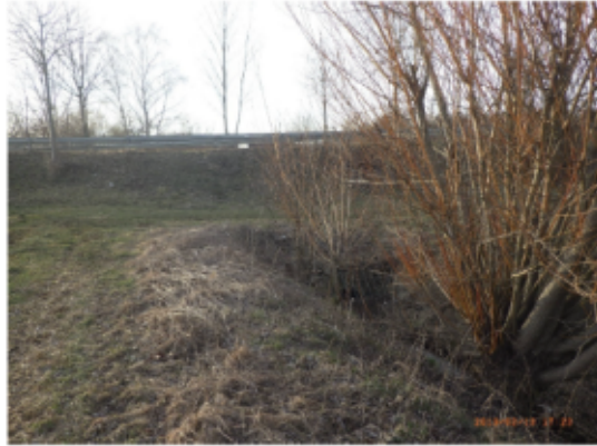
Abbildung 50: Verdolungseinlauf des Klingelbrunnenbachs vor dem der L 1152
